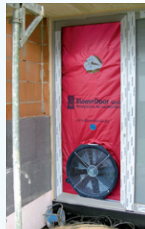
BlowerDoor Messung eines neu gebauten Einfamilienhauses
